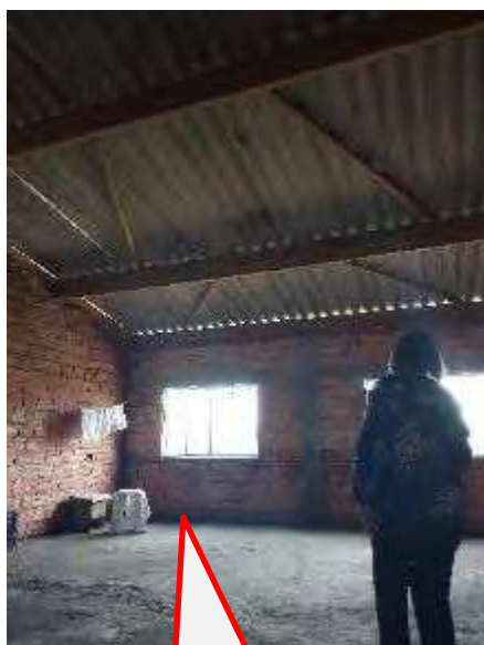
Vista da cobertura feita pela Sra Isabel, em 2021. Interior do 2º Pavimento do imóvel objeto da perícia.
