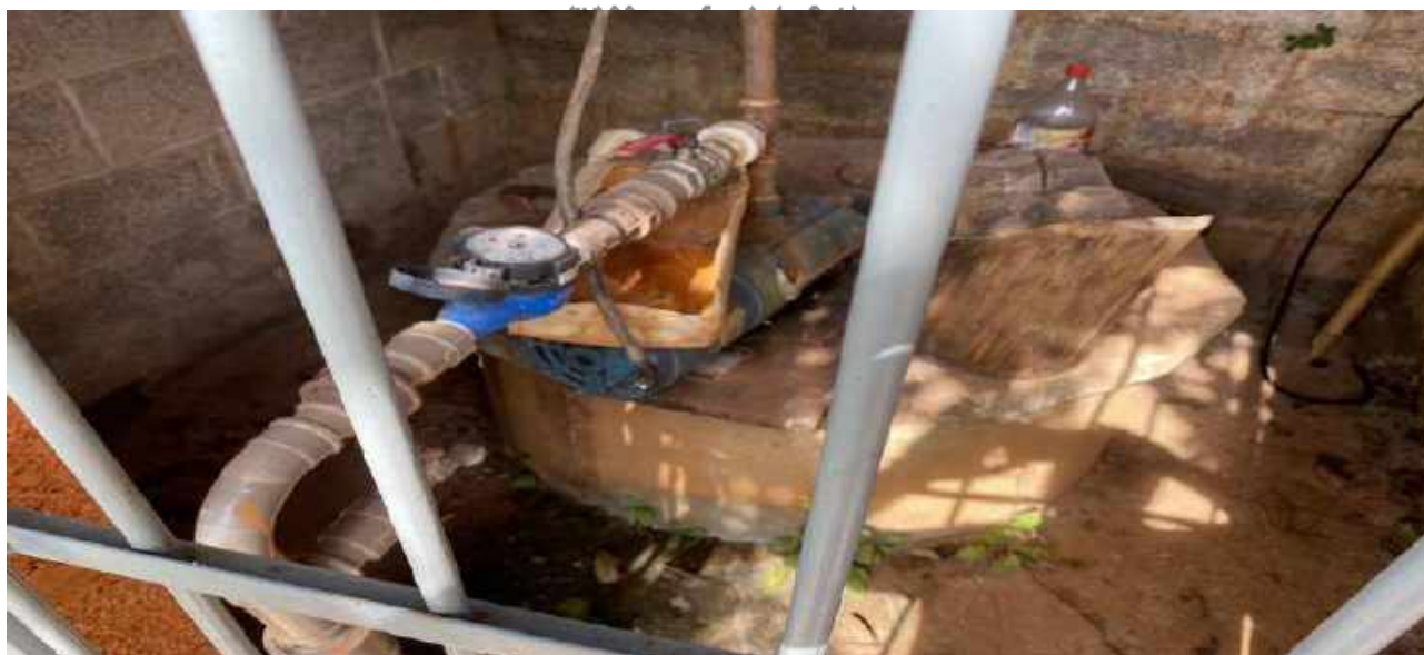
VISTA POÇO ARTESIANO
