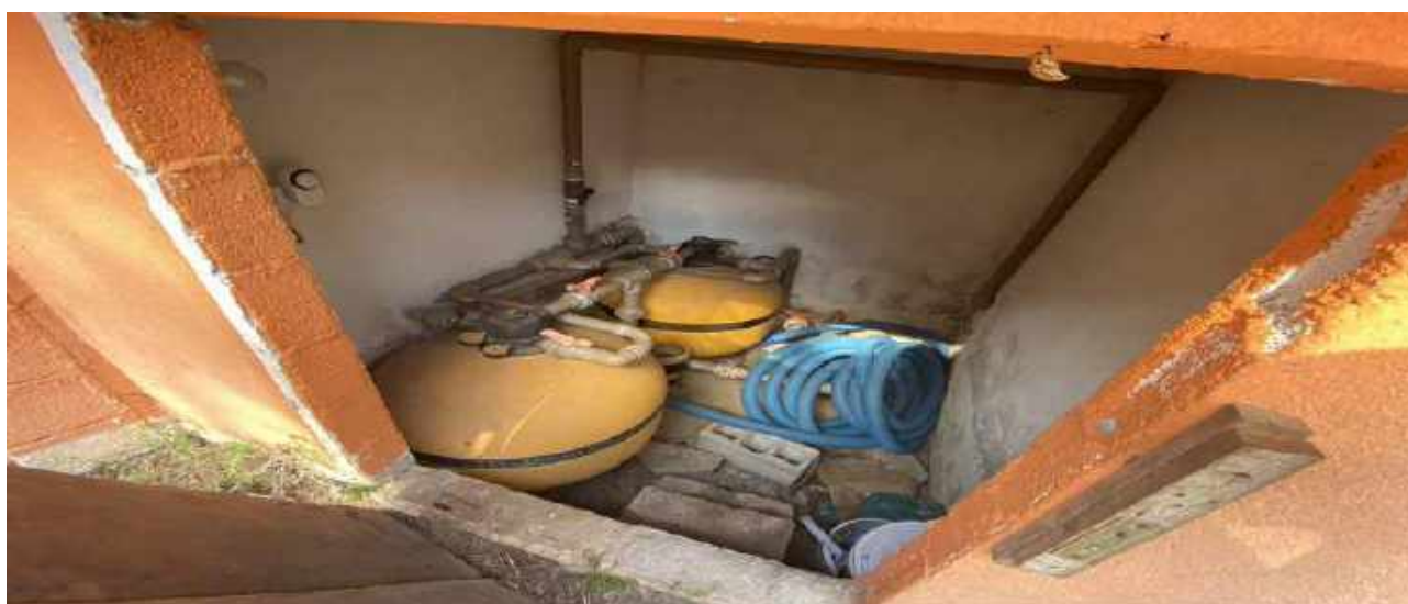
VISTA CASA DE MÁQUINAS PISCINAS
