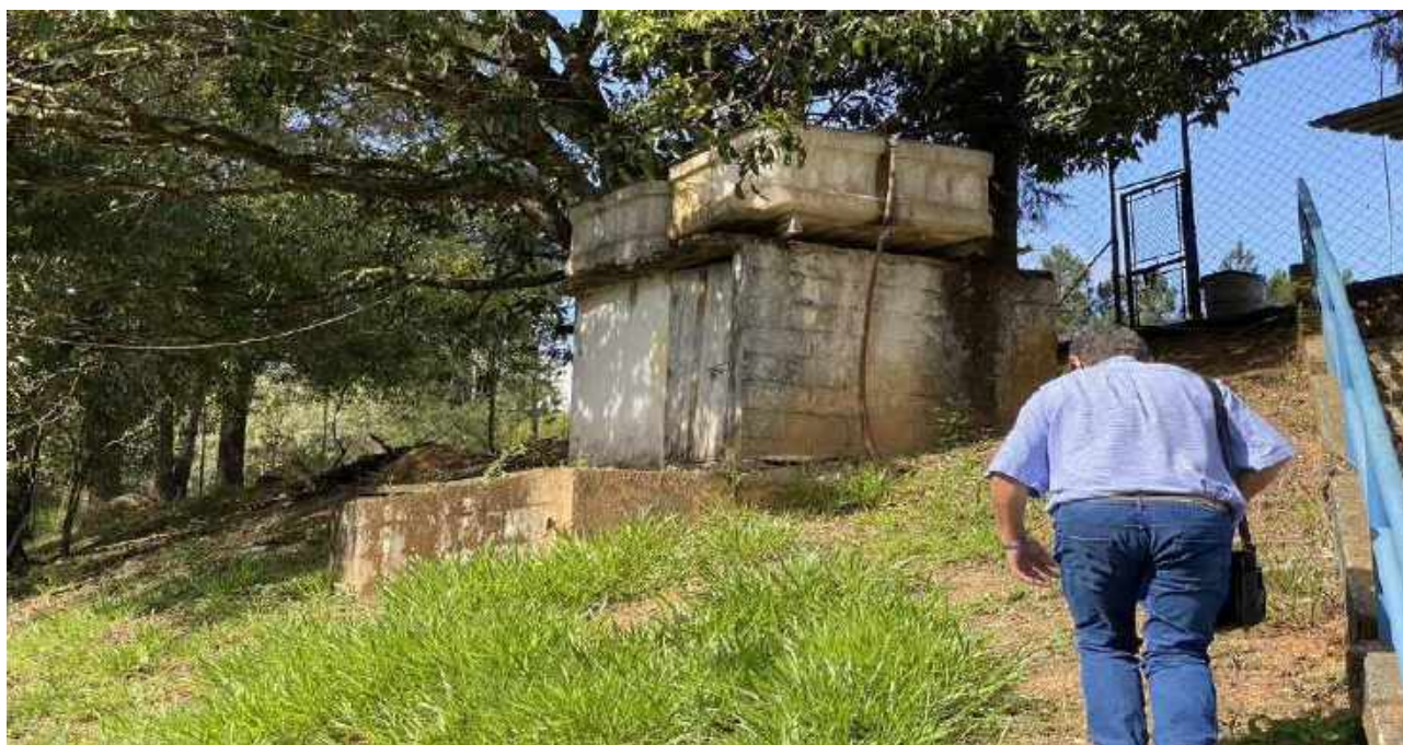
VISTA POÇO ARTESIANO
