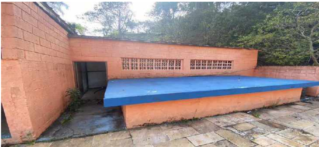
VISTA CASA DE MÁQUINAS PISCINAS
