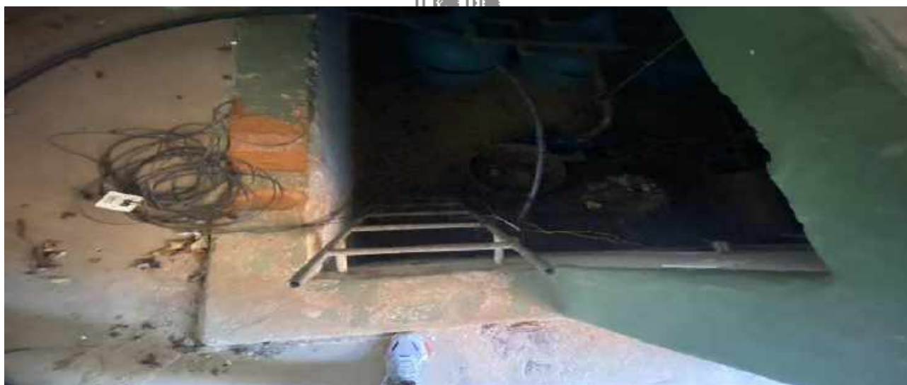
VISTA CASA DE MÁQUINAS PISCINAS
