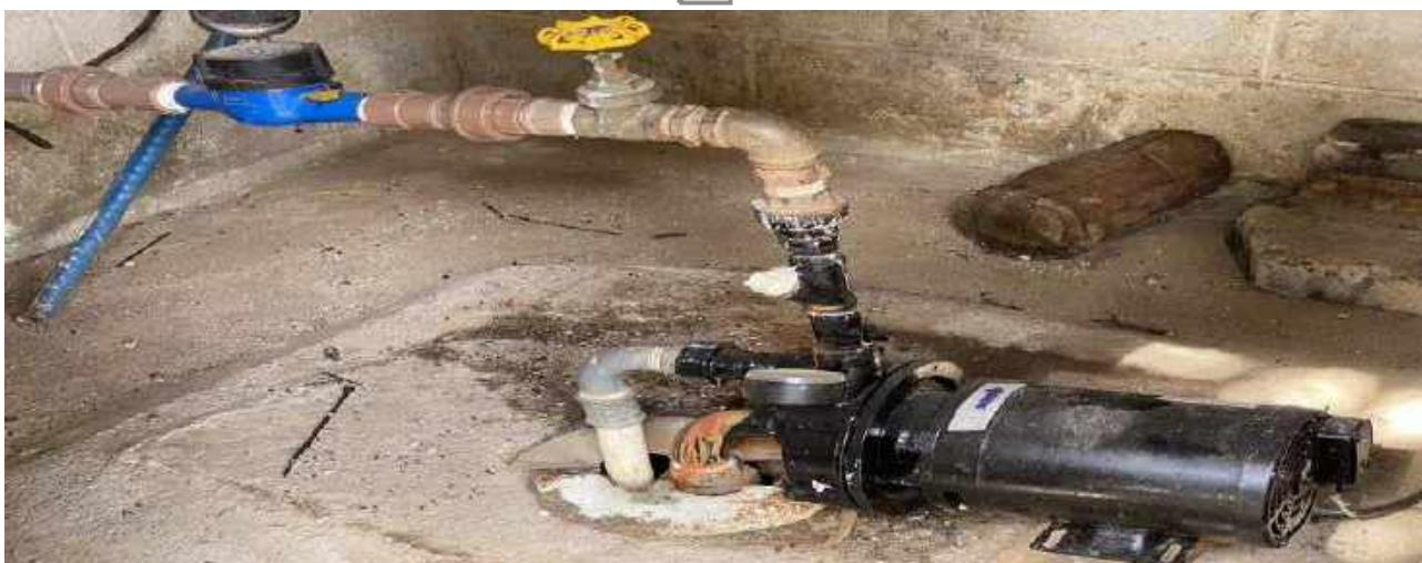
VISTA POÇO ARTESIANO
